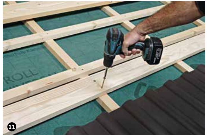
11 Hilfsbohlen montieren. (Querschnitt siehe Tabelle Bemessungslasten und Befestigungsvarianten Seite 3) Befestigung mit Würth ASSY plus 6,0 x 120 mm. Bei Aufsparrendämmung oder Schalung entsprechend längere Schrauben verwenden.
