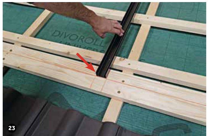
Die Drainage-Schienen an der horizontalen Abschnürung ausrichten und mit Senkkopf-Schrauben (z. B. 3 x 30 mm) befestigen. Weitere Drainage-Schienen überlappend verlegen.
