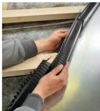
6 Det næstnederste element afkortes, så det kan samles over lægte med det nederste element.
