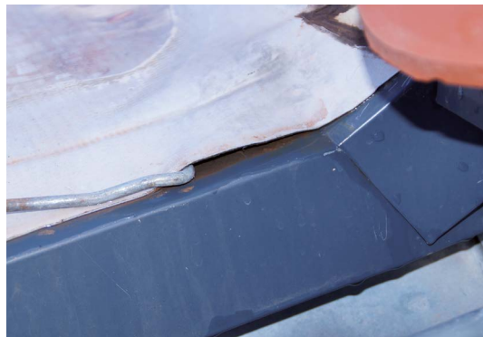
Bei nicht fachgerechtem Anschluss – hier Materialwechsel mit Nahtverklebung – sind Schäden vorprogrammiert.
