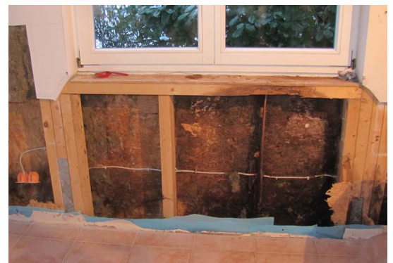
Am falschen Ende gespart: Die Sanierungskosten übersteigen die Kosten einer fachgerechten Sockelabdichtung um ein Vielfaches.
