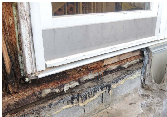
Der missglückte Versuch einer Sockelabdichtung im Gründungsbereich und die fatalen Folgen.
